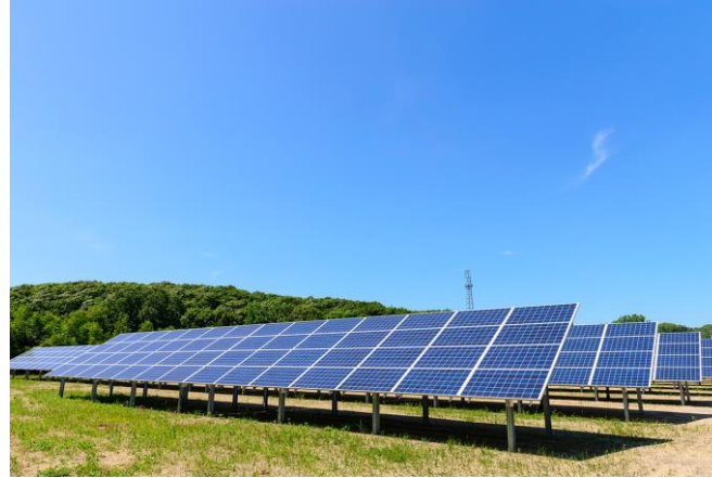
太陽光発電所
